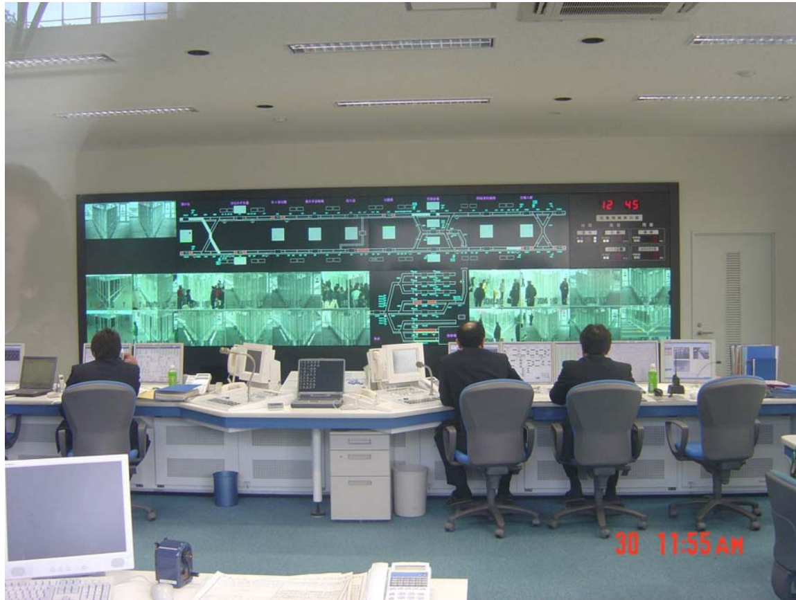
機廠行控中心
