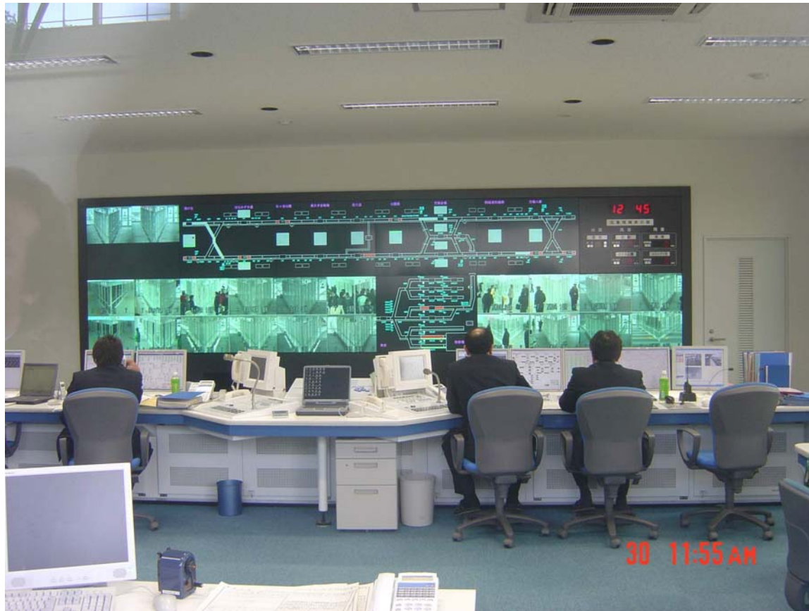
機廠行控中心
