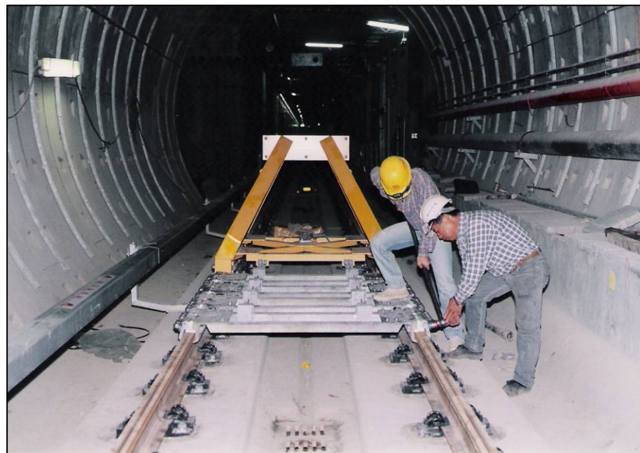
圖34 止衝擋消能組件 螺栓扭力量測 (消能組件螺栓扭力 150 \pm 10 \text{kN} )
